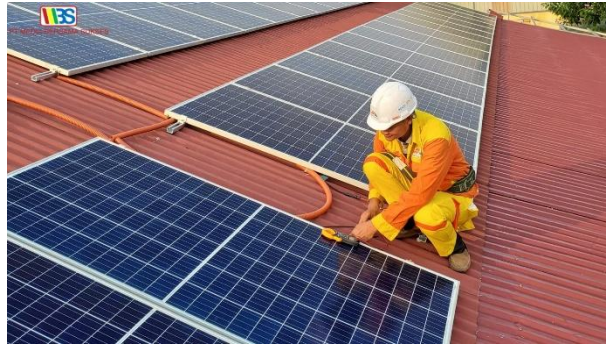
Gambar 2. 1 Pemasangan PLTS pada atap sebuah bangunan. Sumber : (Mbscctv.com, 2024)
